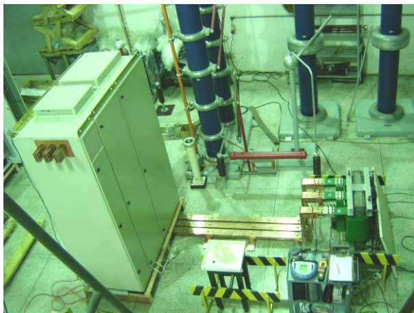
Fig.03 – QGBT no ensaio de elevação de temperatura em 2000 A.
