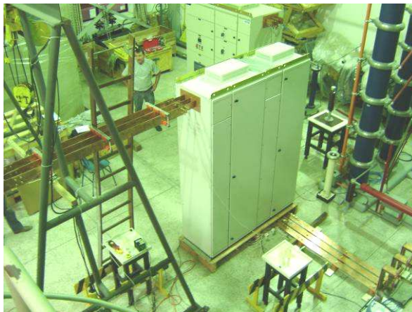
Fig.03 – CCM no ensaio de elevação de temperatura em 1250 A.
